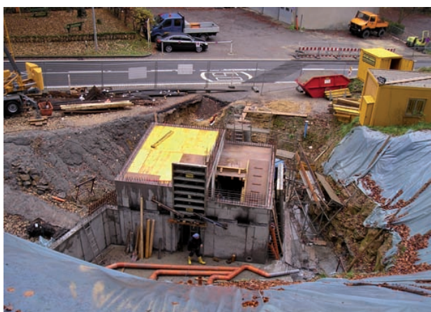
Renouvellement du bassin de captage des eaux de la source «Eisebur» en 2009
